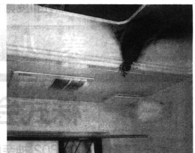
焼けた風呂場の天井
