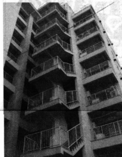
東電借室からの幹線部分
